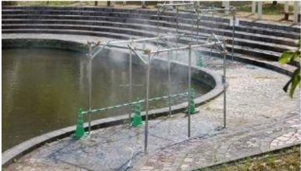
写真1左上 ミストシャワー（多目的広場ふれあいの池）
